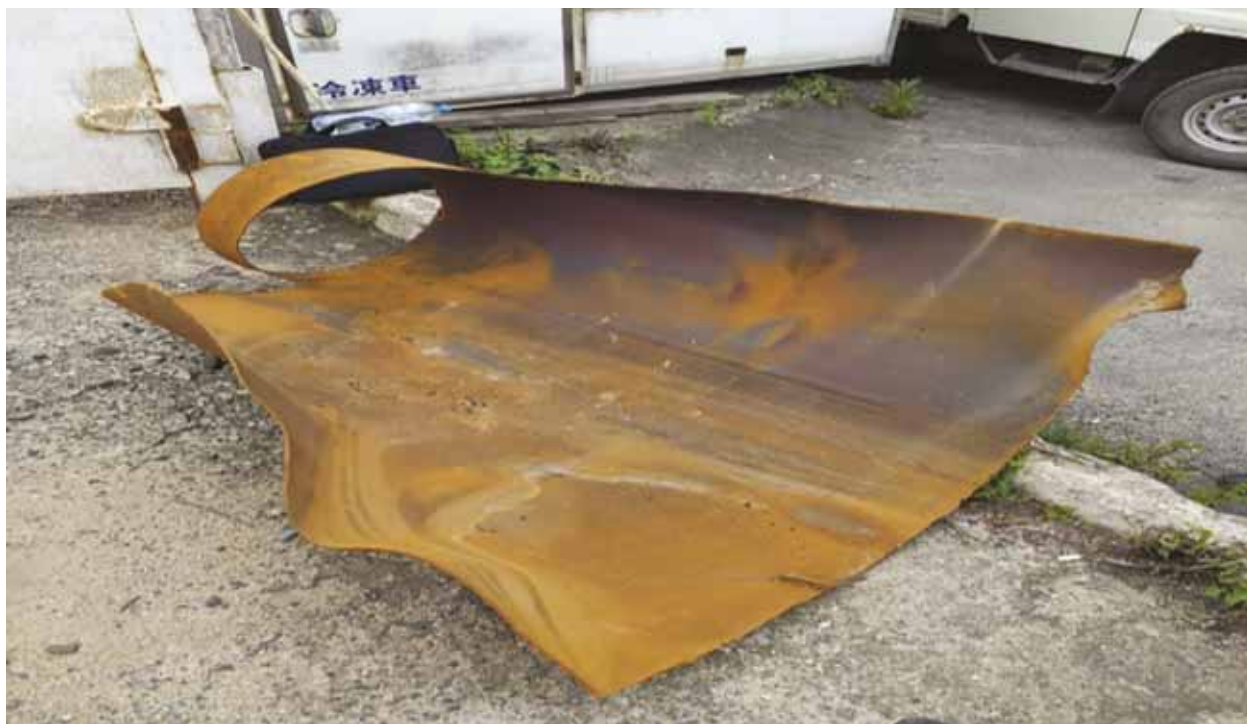
Рис. 35. Порыв паропровода на участке трубопроводов, эксплуатируемом СП «Приморские тепловые сети», г. Владивосток
