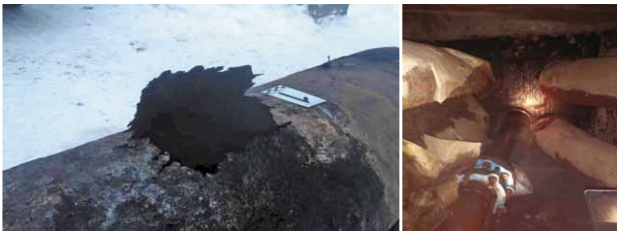
Рис. 32. Разрыв трубы Ду 400 в ООО «Пермская сетевая компания», г. Пермь
