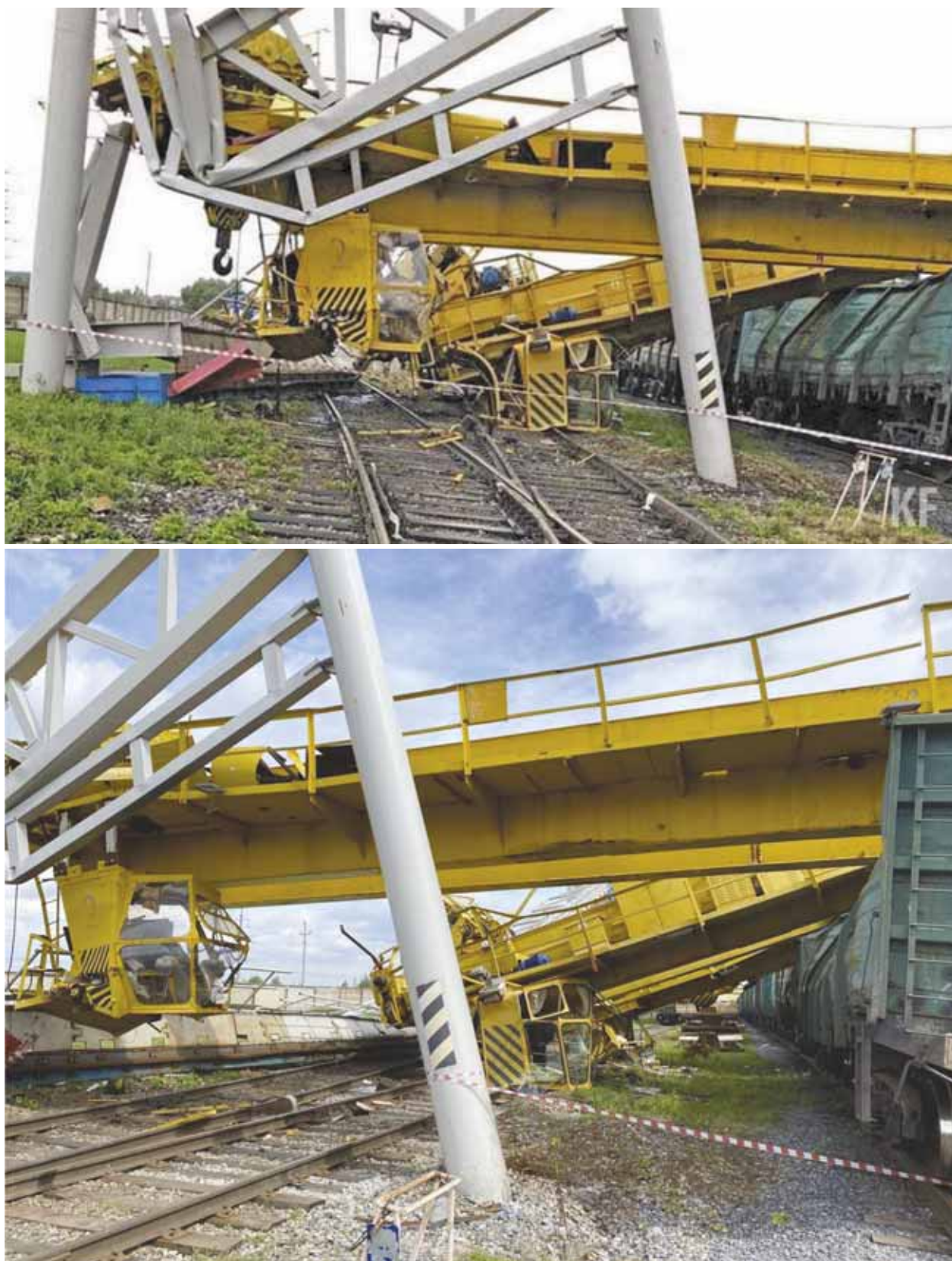
Рис. 49. Результат падения трех мостовых кранов в АО «Набережночелнинский трубный завод ТЭМ-ПО» (г. Набережные Челны)
