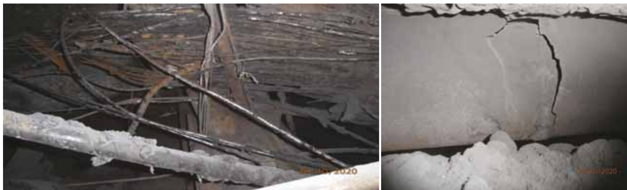
Рис. 36. Неконтролируемый выход большого количества шлака из шлаковых бункеров на ОПО «Площадка главного корпуса ГРЭС», г. Калтан
