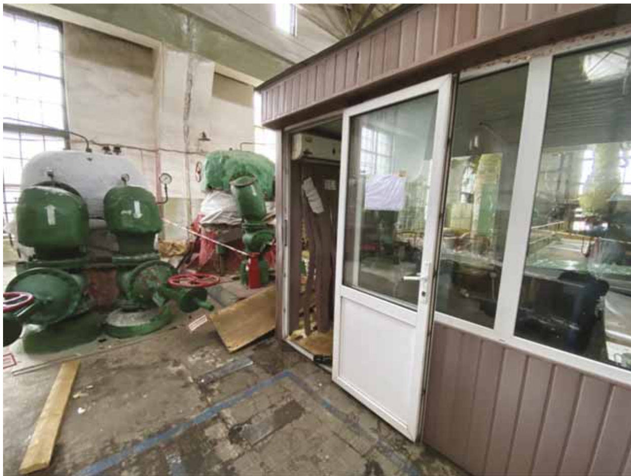
Рис. 34. Авария в котлотурбинном цехе ПП ТЭЦ-2
